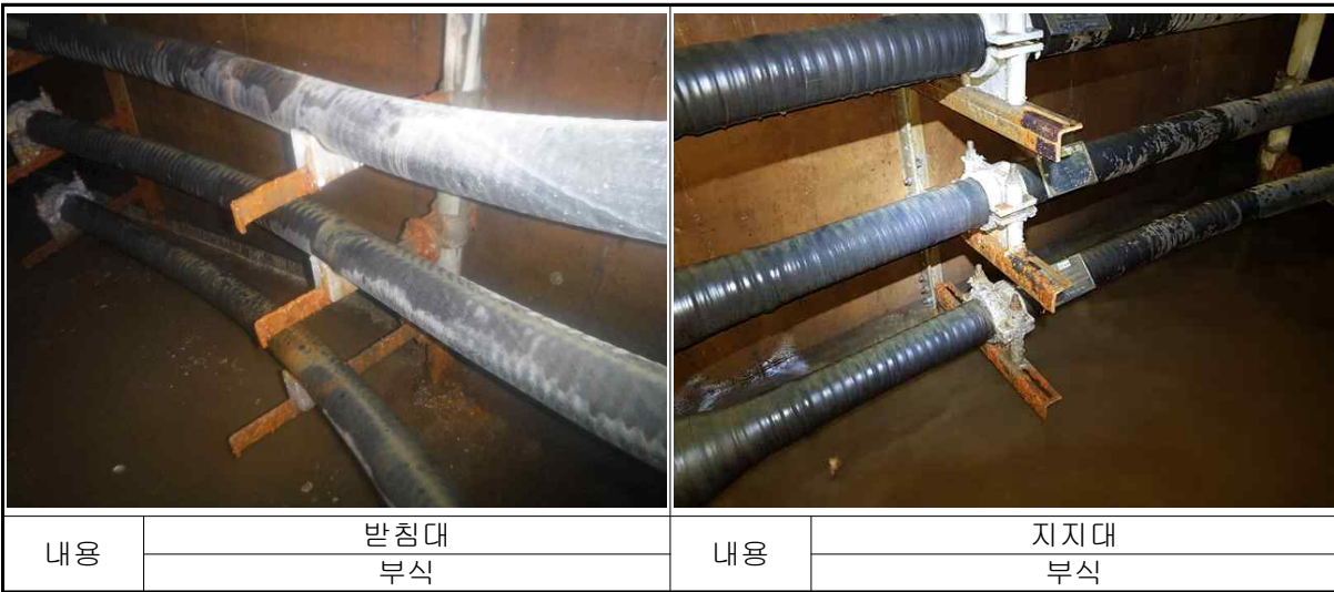
【사진 12.32】 부속 및 부대설비 현황
