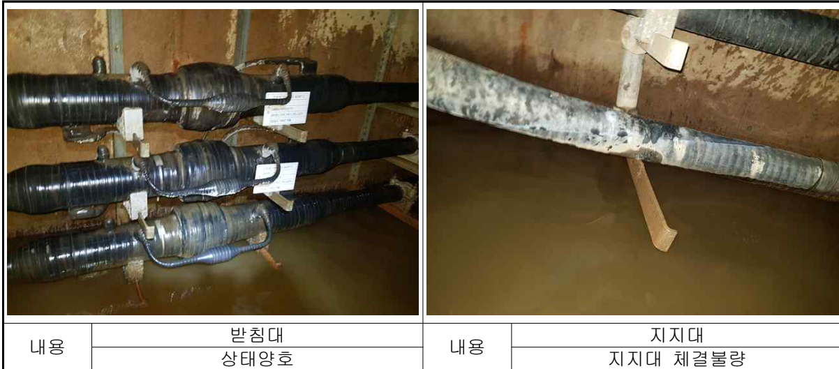
【사진 12.44】 부속 및 부대설비 현황
