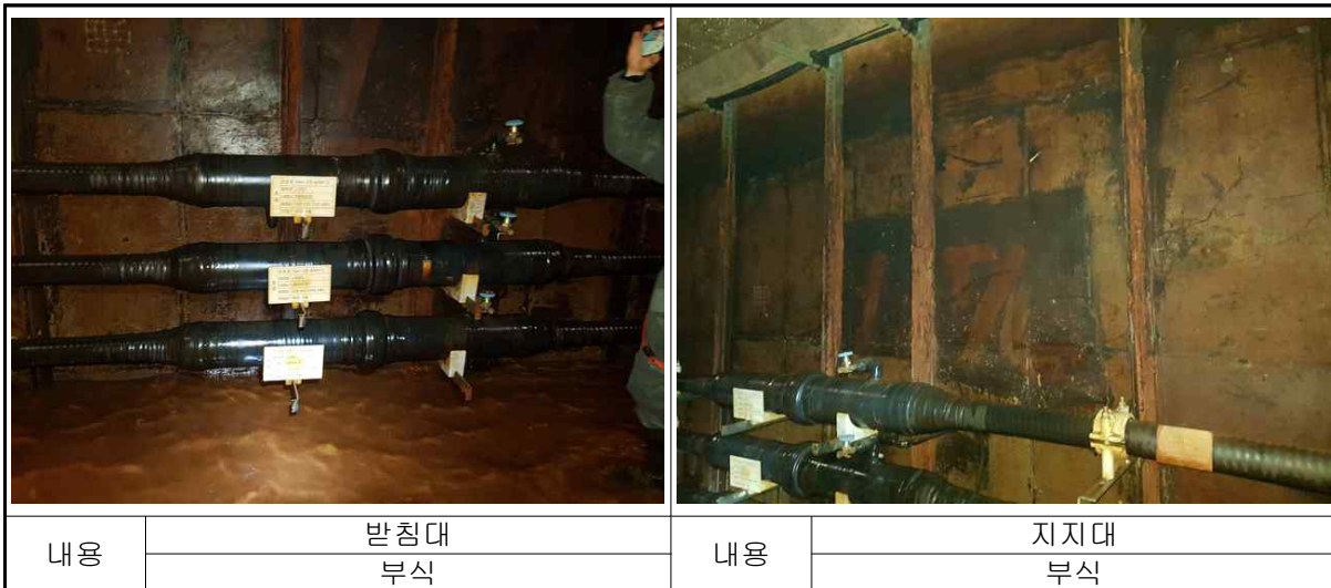
【사진 12.12】 부속 및 부대설비 현황
